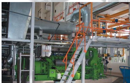
Когенерационная установка Jenbacher JMS 416
