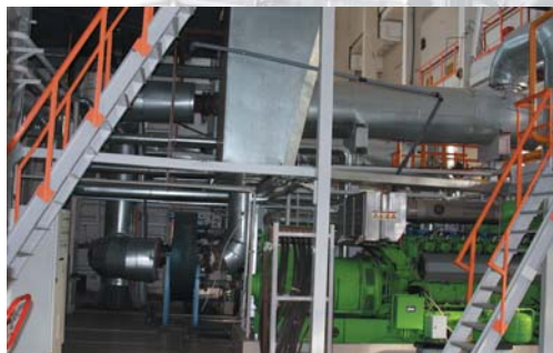
Газо-водяной теплообменник и ГПА
