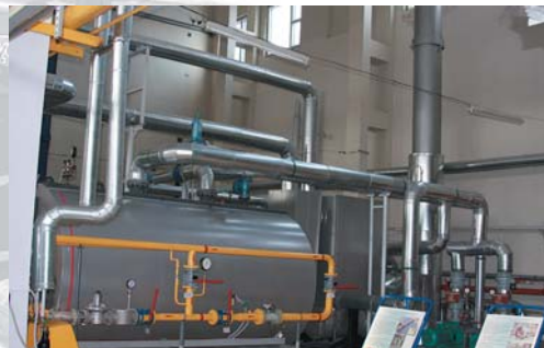
Водогрейный котел Vitomax 300
